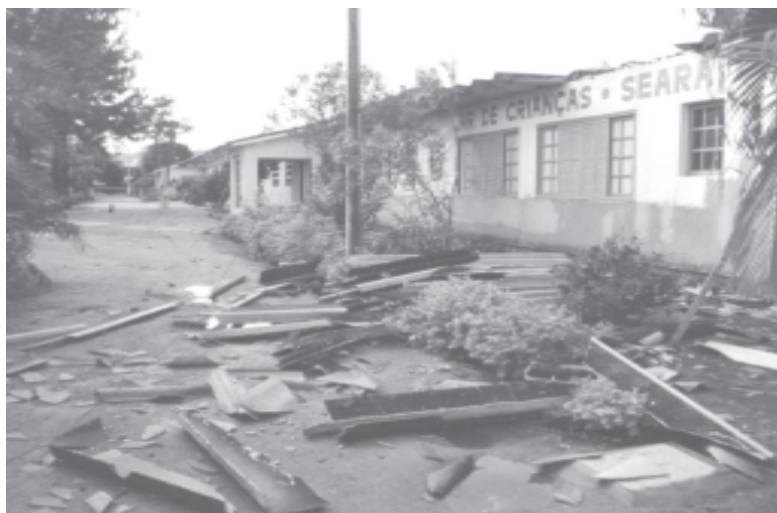
Destelhamento provocado por um vendaval. 1994
