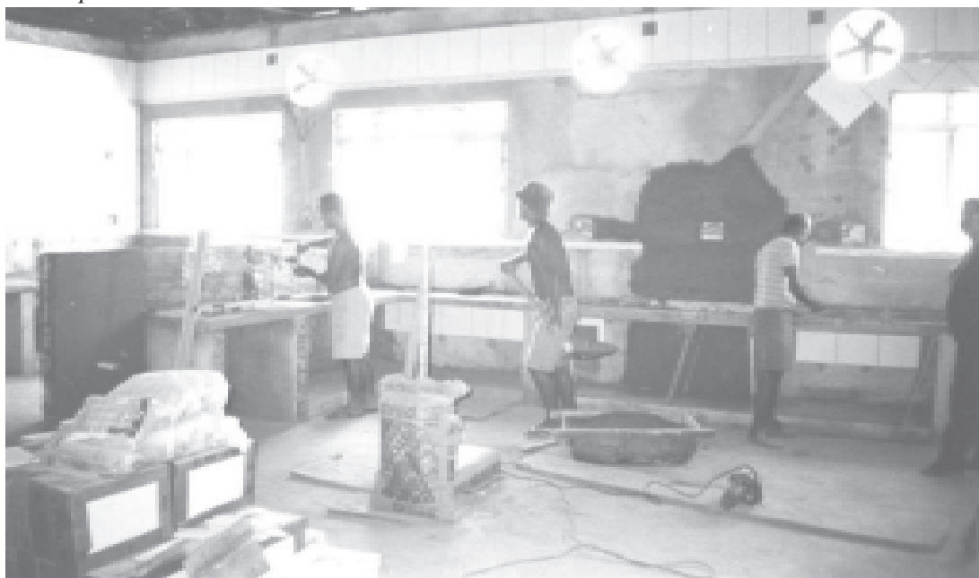
Reforma da cozinha do Lar dos Velhinhos, que a transformou em COZINHA INDUSTRIAL. 2003.
