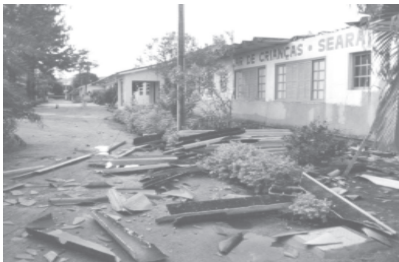
Destelhamento provocado por um vendaval. 1994
